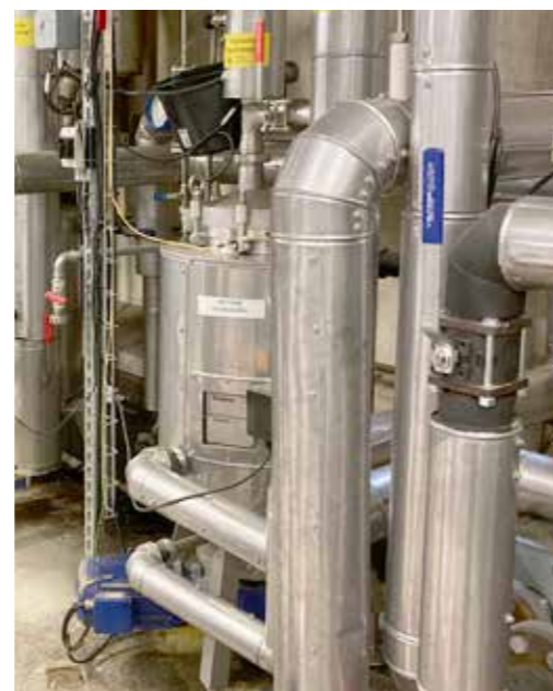
Bild oben: Leitung mit Schauglas zur Überprüfung des Lecithins und darunter die Pumpe zur Beförderung nach hinten zu den Kühlern.
