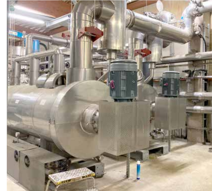
Die Dünnschichttrockner, oberhalb der Tropfenabscheider und rechts davon die isolierten Kondensatoren. © GIG Karasek
