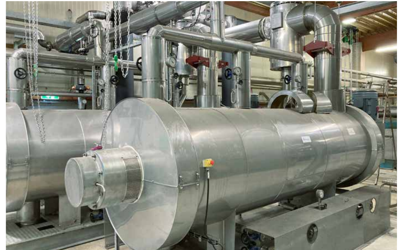
Die beiden parallel installierten Dünnschichttrockner bei Power Oil Rostock. © GIG Karasek
